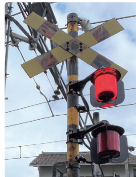
全方向型踏切閃光灯
